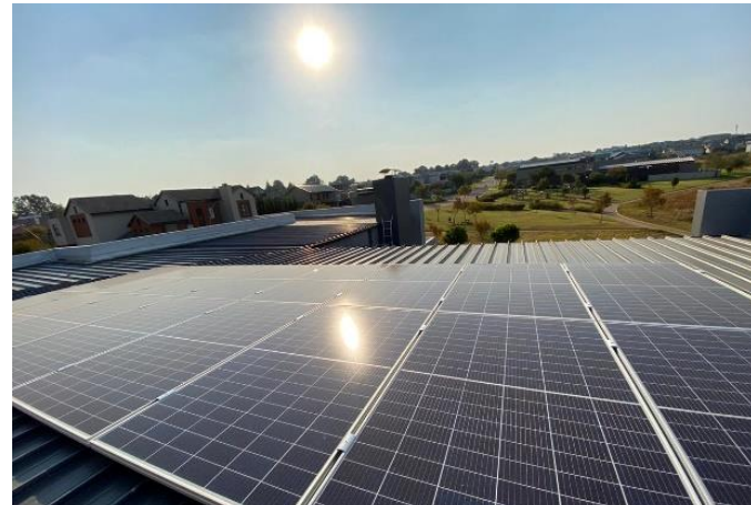
Home, Gauteng, SA 10 kWp & ESS (2020)
