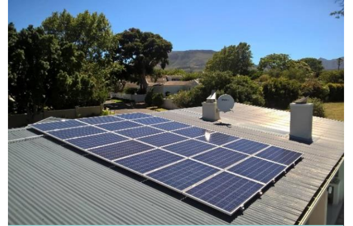
Home, Western Cape, SA 5 kwp & ESS (2018)
