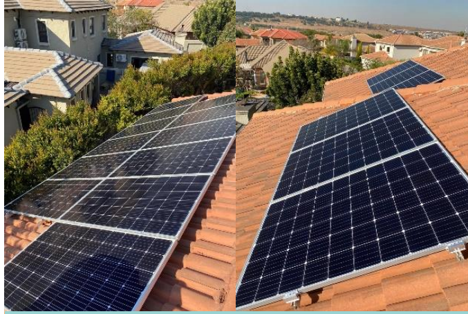
Home, Gauteng, SA 5 kWp & ESS (2020)
