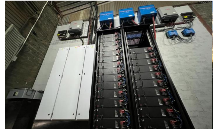
Off Grid system, SA 44.5 kWp, 120 kWh (2022)
