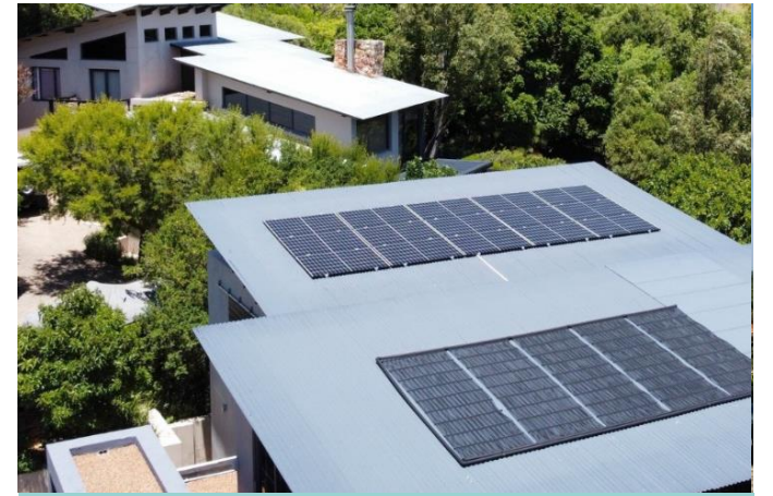
Home, SA 5.5 kwp & ESS (2022)
